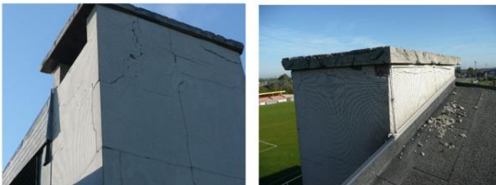
Vue de la cheminée en très mauvais état.
