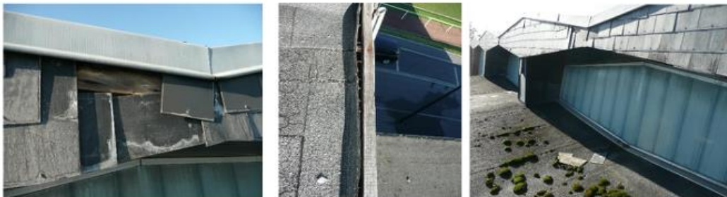
Vue des ardoises en bardage et de la costière manquante.
