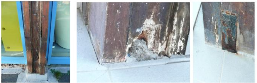
Vue des pieds de poteaux lamellé-collé en très mauvaise état
